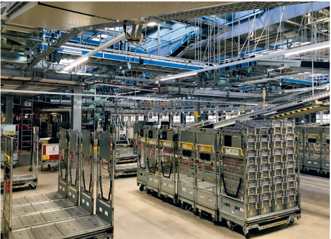
Erdgeschosshalle des Briefzentrums mit Förderanlagen und Sammelbehältern für die Briefsortierung Foto: Christoph Köchli
